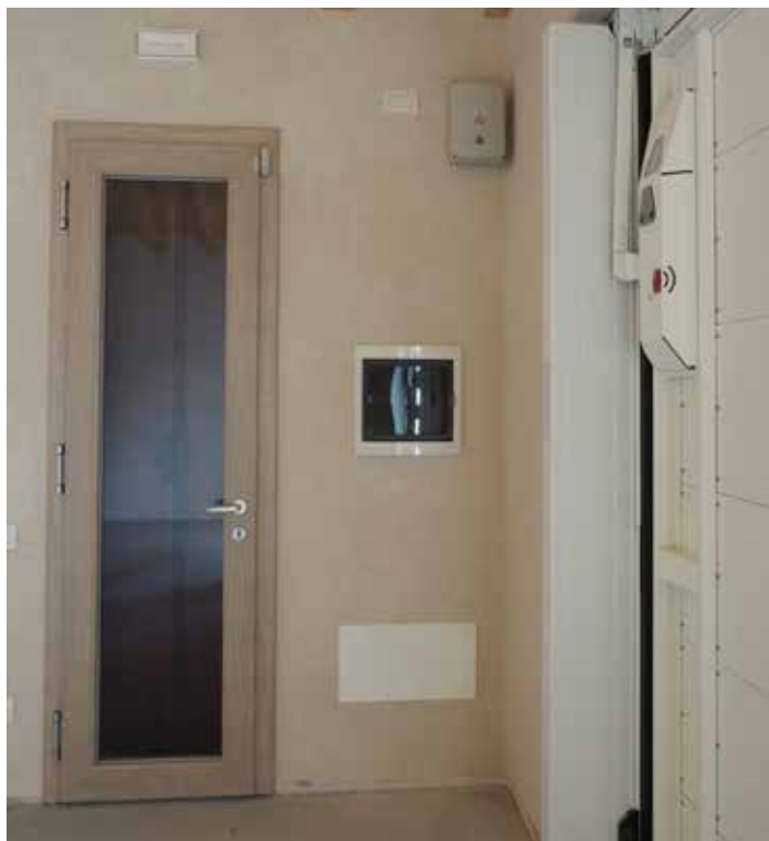
Vista interna garage con Kit BoxAlarm
