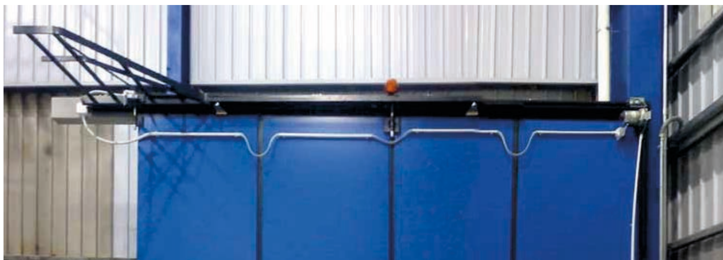
Vista interna portone a libro Anteo con motorizzazione meccanica a cremagliera completa di motore 24 V, installato su anta.
